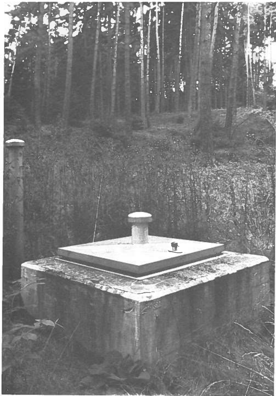
Quellsammelschacht Densberger Quellen
