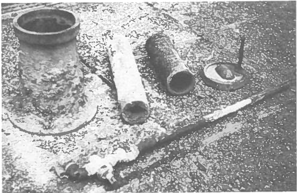
Bahnhofstraße Jesberg · nahe ehemaliger Kreissparkasse: v.l.n.r.: Anschluß, oben 160 mm (innen), unten 300 mm; Rohr, Länge 425 mm, \varnothing innen 60 mm; Mantelstärke 9 mm; Rostbelag bis zu 25 mm; Rohr: Länge ~275 mm, \varnothing innen 70 mm; Mantelstärke 8 mm; Aufsatz: \varnothing 158 mm; vorn: Zuleitungsrohr zum Verbraucher: Länge ~650 mm; \varnothing innen 20 mm; Mantel 2 mm
