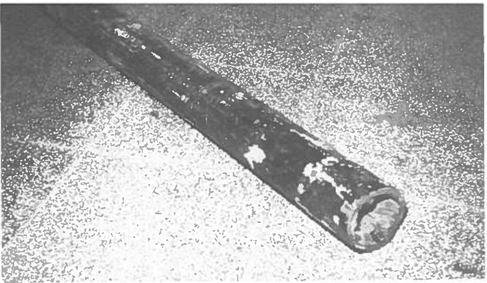
Wasserleitungsrohr ca. 75jährig · Eisenrohr · Fundstelle: Bahnhofstraße Jesberg · Innen- \varnothing : 67 mm
