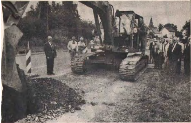
Ein GROSSEN BAGGER setzte der Präsident des Landesamts für Straßenbau, Professor Eberhard Knoll, selbst in Gang und startete damit die Arbeiten zum Rückbau der Bundesstraße 3 in Jesberg. (Foto: Haun)
